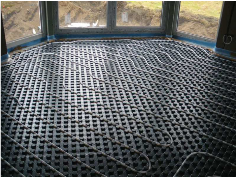
Flächentemperierung ist energieeffizienter und behaglicher
