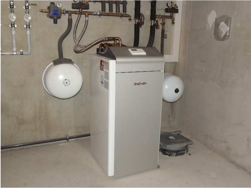
Die Wärmepumpe hat die Größe eines kleinen Kühlschranks
